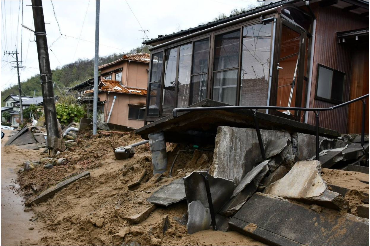
奥能登の震源域から約100km 離れた内灘町を襲った「側方流動」液状化現象。家の床下を右から左へ、地中の砂層が流れ、地表へ噴出し、土台ごと持ち上げた(2月9日、内灘町で)
